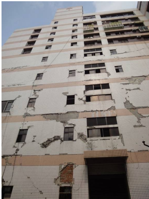
↑ 現況磁磚嚴重剝落
