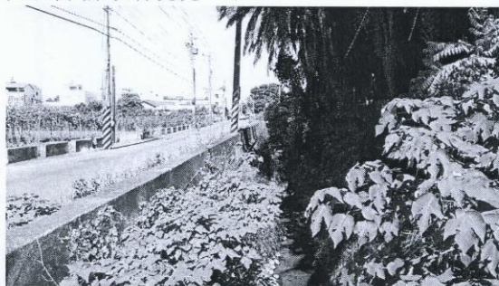
仁里村排水溝現況
